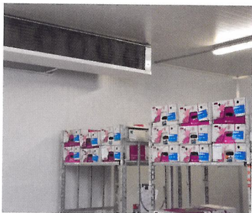
Afb. 2.95 De koelcel is een afgesloten ruimte op een bedrijf waar de ingestelde temperatuur en luchtvochtigheid behouden blijft.
